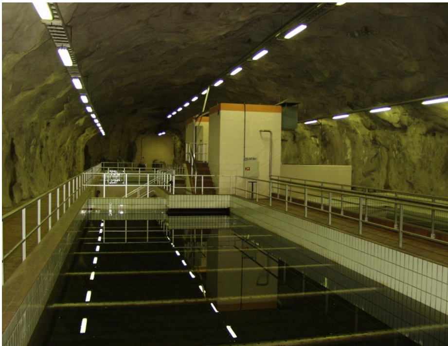
Bilde 5 viser deler av NRVs renseanlegg.
