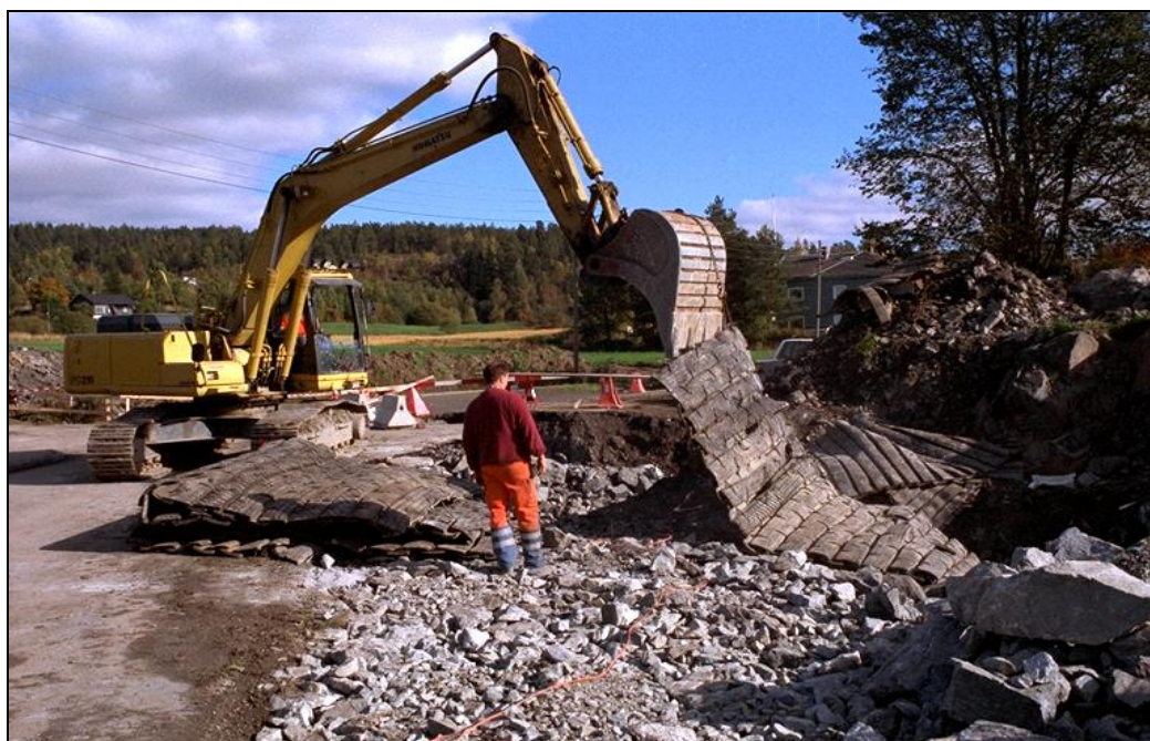
Bilde 19. Sprengninger kan representere en fare både for anleggsarbeidere og omgivelser.
