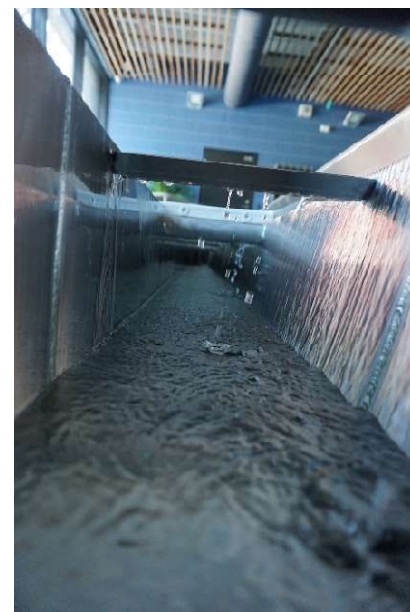
Figur 33 - Overløpsrenne Åfjord (Foto: Ole B. Brueng)
