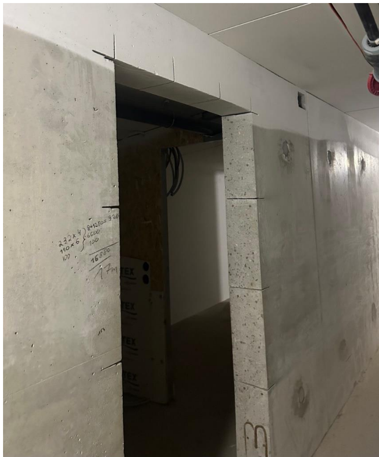
Figur 27: Fra befaring på prosjekt D hvor det har blitt skjært ut en utsparring i ettertid, noe som er et resultat av manglende prosjektering.
