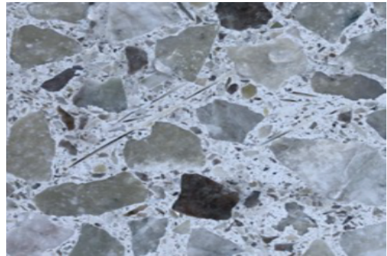
Figur 3 Slipt overflate på MiniBars™-armert gulv
