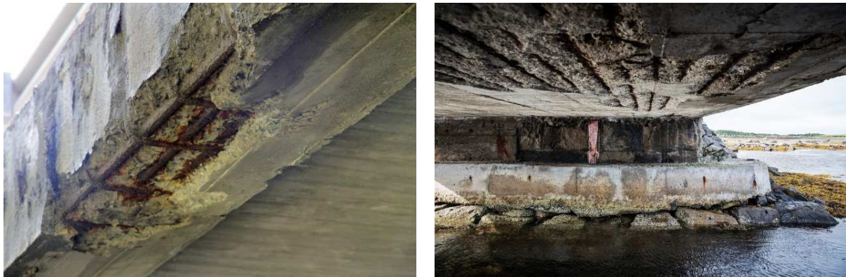
Figur 1.1-1: Korrosjonskader på Huldalskilen og Strauman 3. Typiske korrosjonskader på norske bruer. Kilde: VG.no De forsømte broene 2017.
