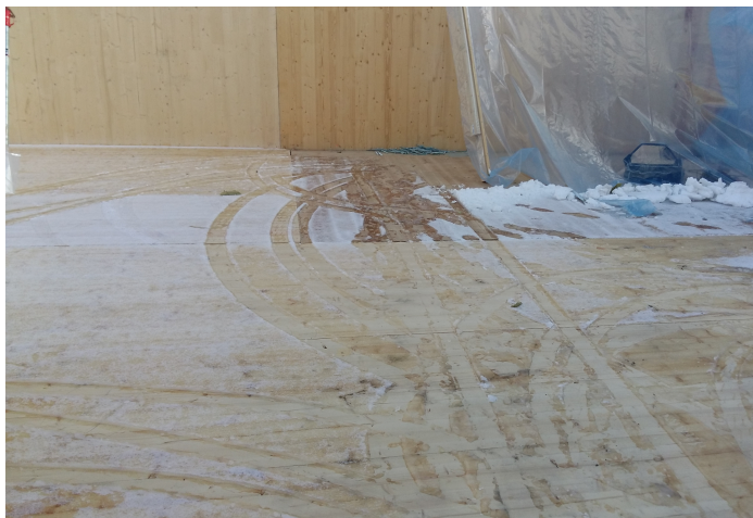
Figur 46. Bilde av en etasjeskiller i massivtre utsatt for nedbør under byggingen av Bjørkelangen skole. (Foto: Privat, Bjørkelangen skole)
