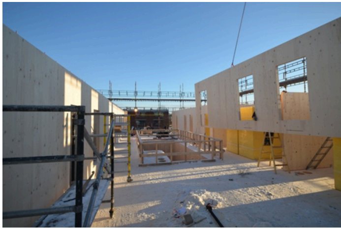
Figur 45. En vegg av massivtre heises på plass under byggingen av Bjørkelangen skole [5].
