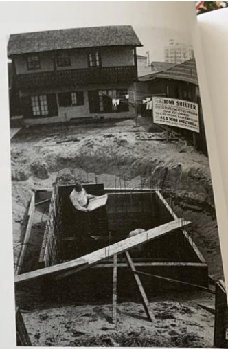
▲ Frykten for atomkrig var så stor at en del familier bygde sine egne private bomberom. Her bygges det bomberom i en hage i California i februar i 1951.
