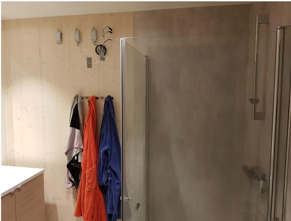
Figur 2.17: viser bilde av TH500, MC501 og T501B montert på massivtre vegg på sone 2/ bad
