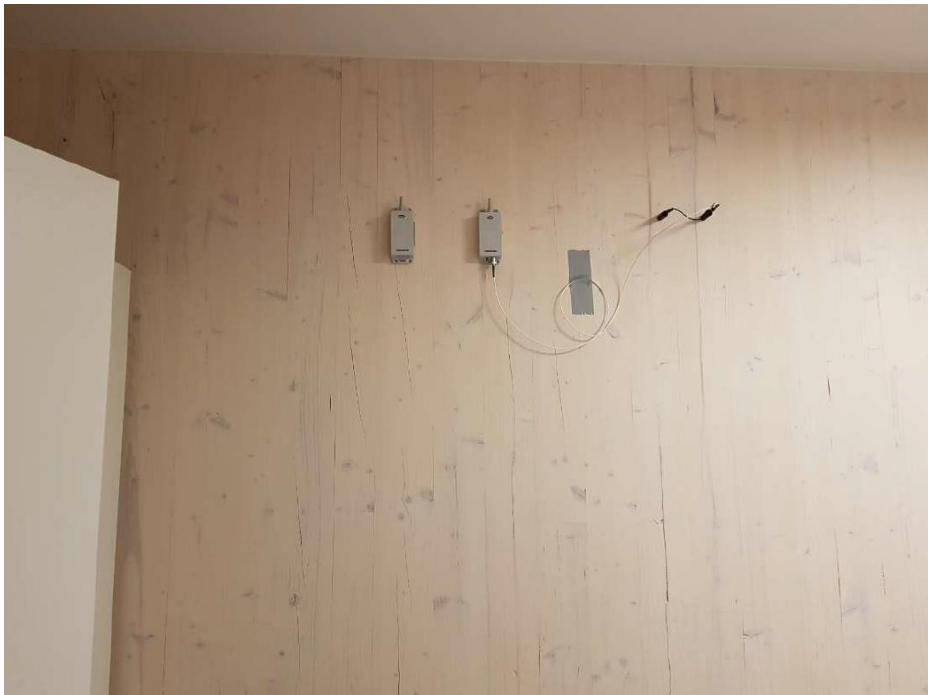
Figur 2.18: viser bilde med plassering av TH500 og MC501 i sone 1/ soverom sør
