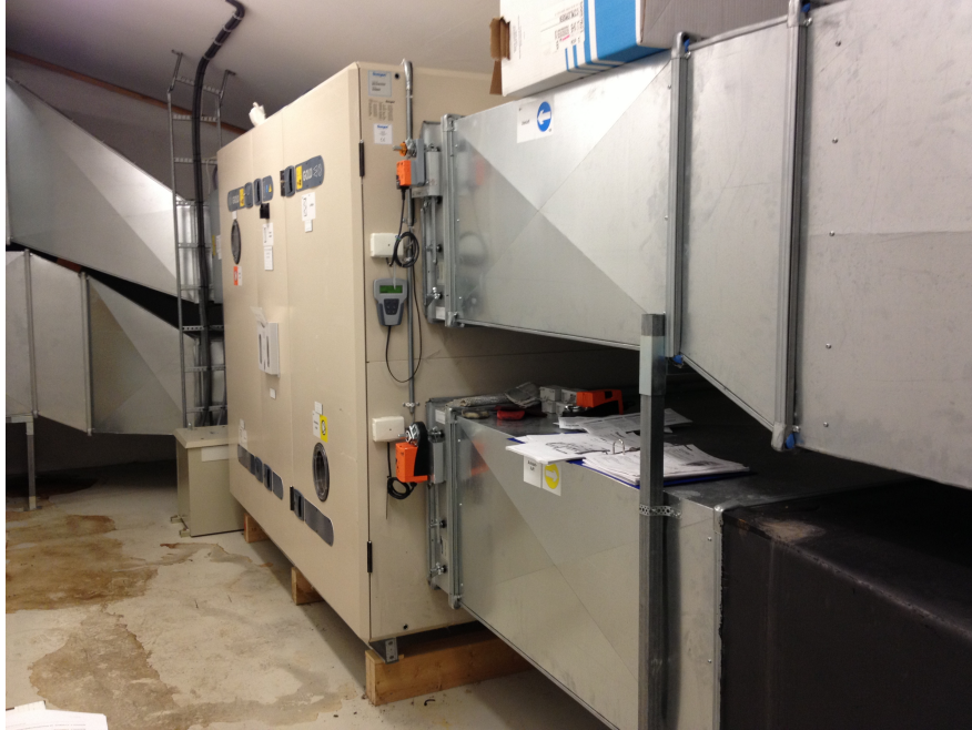
Figur 2.1: Eksempel på kompakt aggregat - Kommer ferdig som en enhet med automatikk fra fabrikk. Foto: Hans Kristian Lundsett
