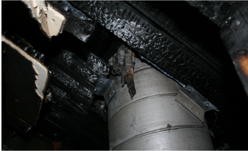
Figur 4.12: Brannen har spredd seg til loftet - Varmeledning har antent treverket på loftet
