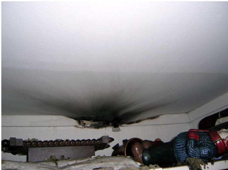
Figur 4.4: Overgang vegg og himling - Dårlig tetting mellom korridor og pasientrom. Foto: DSB
