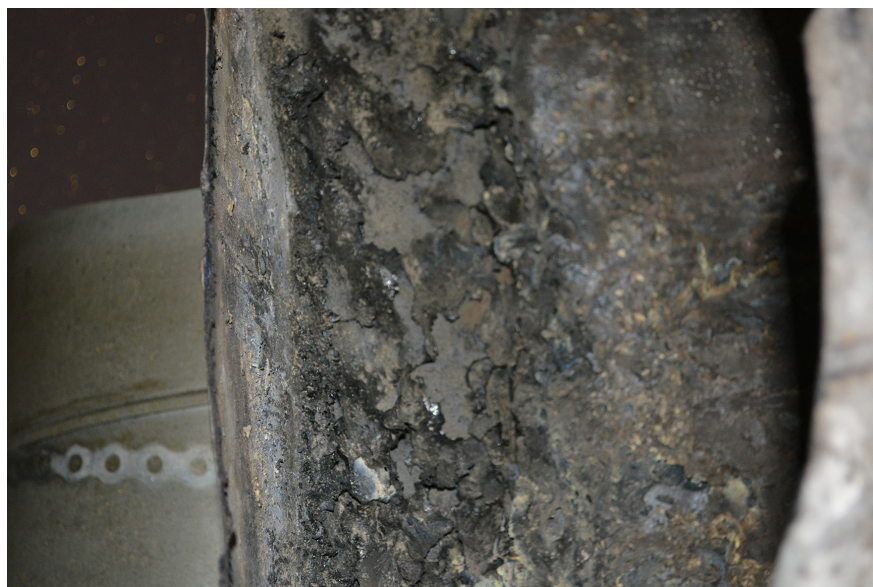
Figur 4.10: Nærbilde innvendig kanal - Bildet viser at fettene innvendig i kanalen har brent.
