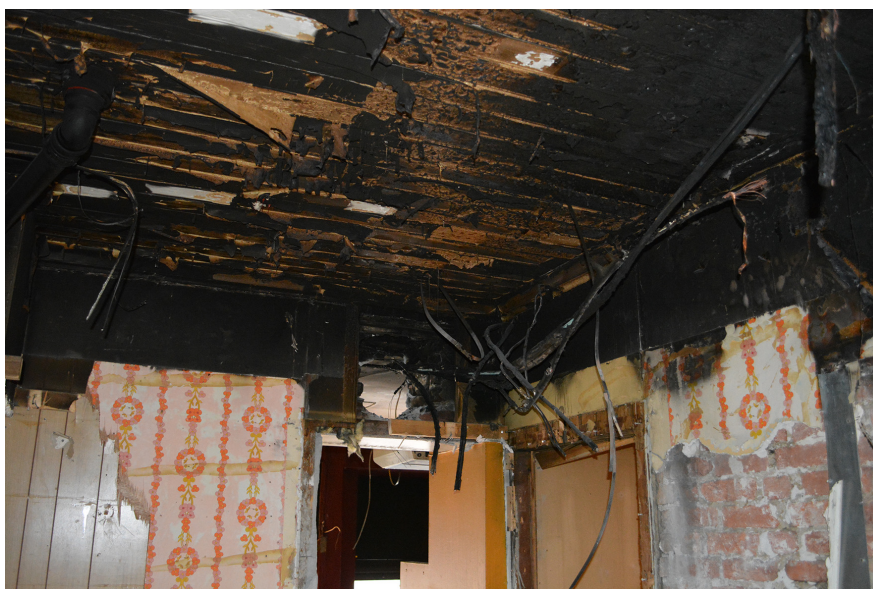
Figur 4.11: Taket på restaurantens bakrom - Kanalen fra kjøkkenet har ført til brann over himling
