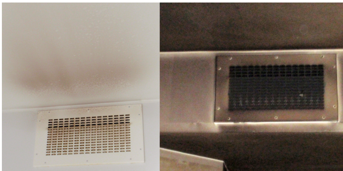
Figur 4.6: Tilluftsventilene på hvert rom - Ventilen i brannrommet er vist til høyre. På bildet til venstre ser man at noe røyk har spredd seg via tilluftskanalen til naborommet.
