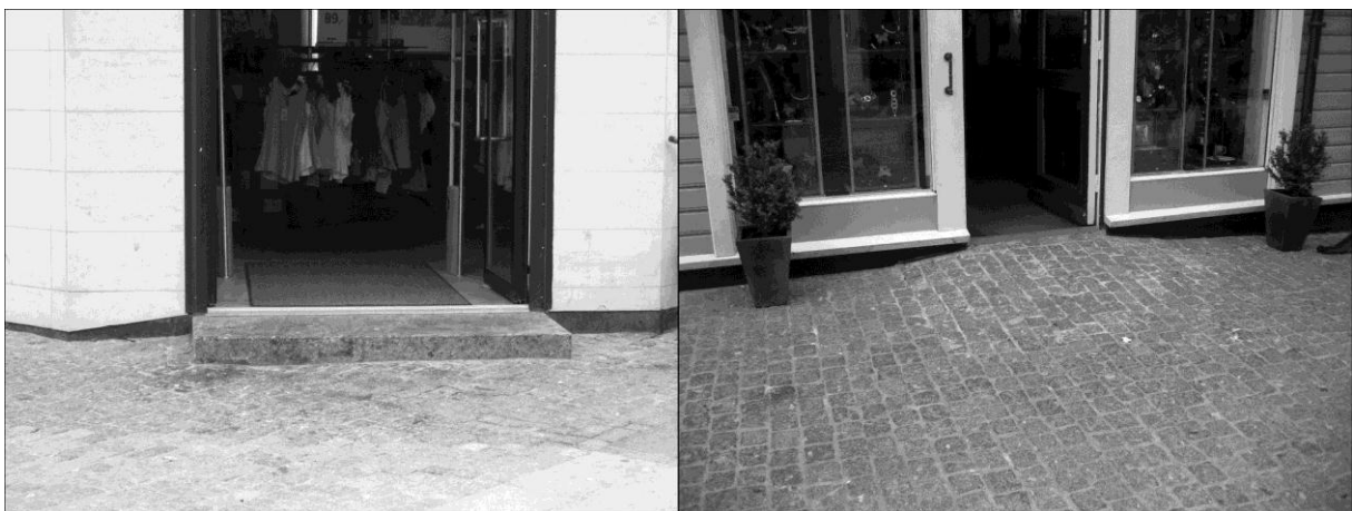
Noen ganger gir enkle og elegante grep universell utforming. Disse inngangspartiene finner vi i Kristiansand. Foto: Tone Moseid
