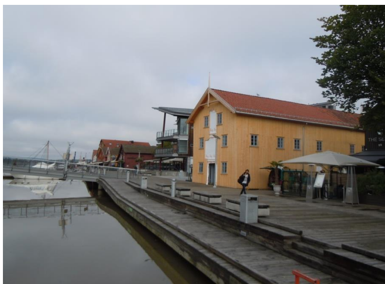
Foto 5.6: Bryggen i Tønsberg, Foyn-gården nordre sjøbod fra øst, under istandsettelse. Nytt bygg er bygget utenpå det opprinnelige sjøbodet
