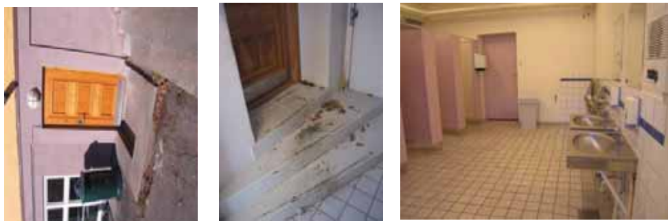
Figur v.99 Toalett med hovedatkomst fra utsiden og trinn både ute og inne i tillegg til høy terskel
