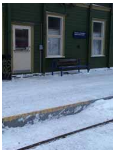
Figur v.40 Stasjonen: Utilgjengelighet ved utilstrekkelige markeringer av perrongkanter og uakseptable høydeforskjeller ved døra til venterommet og planovergangen.
