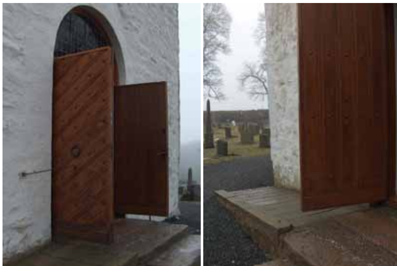
Figur v.26 Rampen til kirkedøra har oppkant, og er utført i gode og korrekte materialer, men er i konflikt med dørslaget. Grusgangene rundt kirken er et ytterligere tilgjengelighetsproblem
