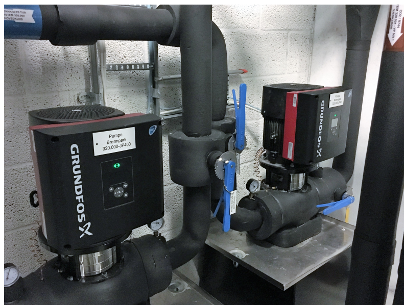
Figur 35: Pumper til energibrønn på Frydenlund skole
