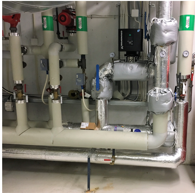
Figur 37: Pumpe på returledning på Frydenlund skole
