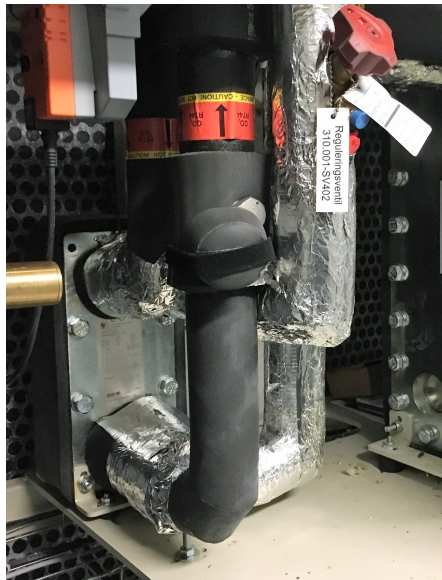
Figur 33: Gasskjøler til tappevann på Frydenlund skole
