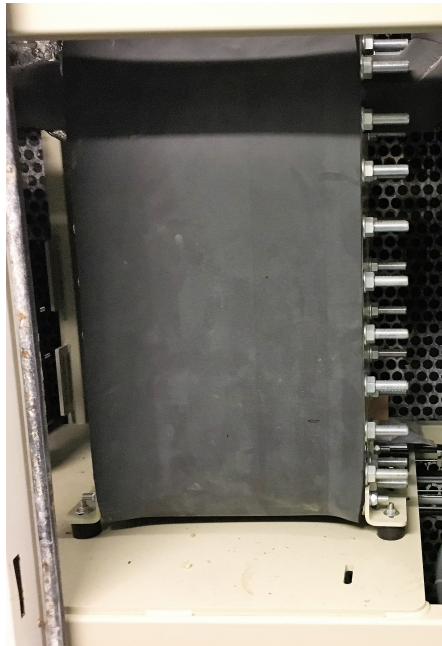
Figur 32: Gasskjøler til varmeanlegg på Frydenlund skole
