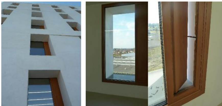
Figur 16: Vindu og side spalte ved «2226» (Halderaker, 2016, s. 24)
