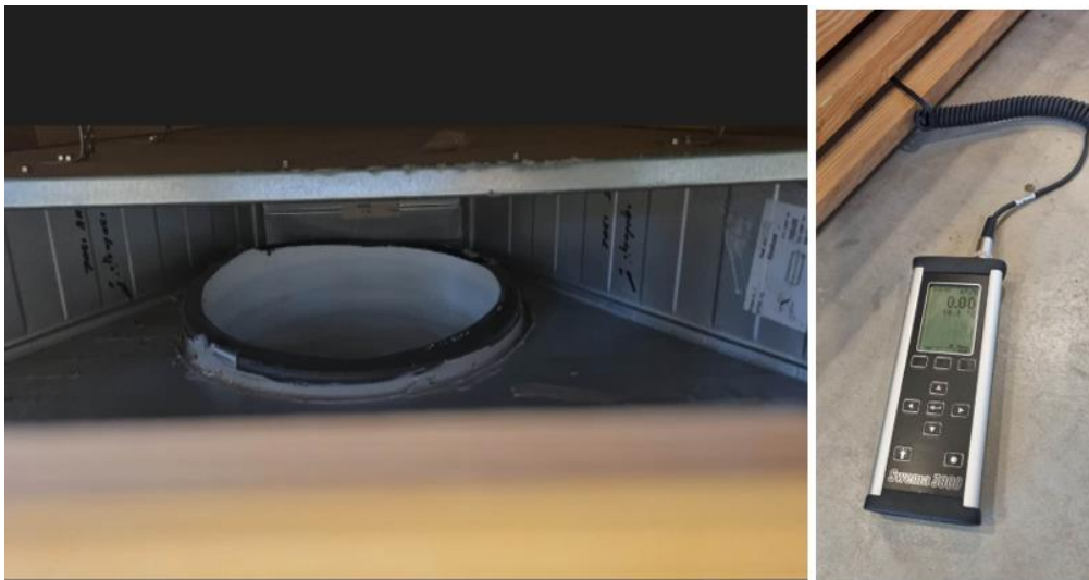
Figur 27: Bilde til venstre er tatt gjennom hullene på trebenken og viser tilluftskanalen under benken i Amfiet, det er mulig å se på vedlegg 14, for ventilasjonstegningen i rommet. Figuren til høyre viser Swema 3000 som måler 0 i luftmengder ved kanalen ved hjelp av Probe SWA 31
