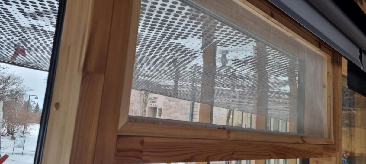
Vedlegg 10: Bilde av motorstyrte vinduer med innvendige solskjerminger
