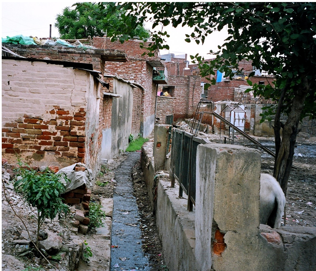
Figur 4 Åpent avløp inntil en lekeplass bygget av slumavdelingen i MCD. Foto Anne Waldrop.
