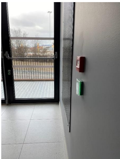
Vifter til trapp D1, lokalisert bak risten.
