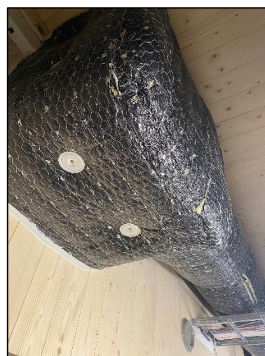
Figur 37: Kanaler for trykkavlastning. Bildet tatt av Jonathan Lundblad 28/02/22
