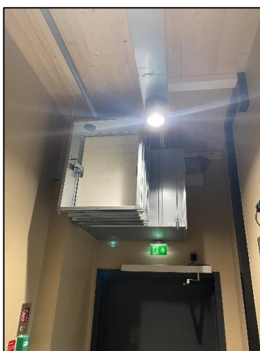
Figur 36: Trykkavlastning, hovedtrapperom i X3. Bildet tatt av Jonathan Lundblad 28/02/22
