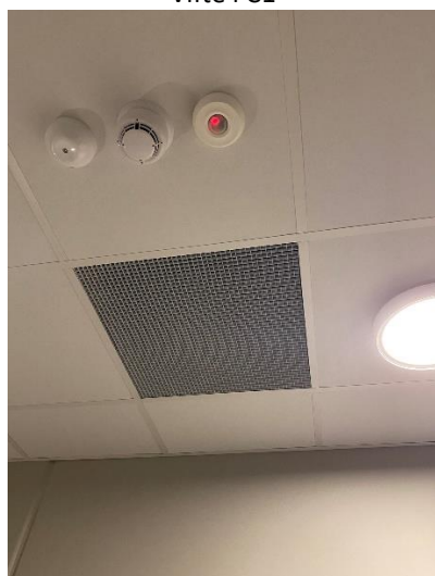
Inntak røykluke C1
