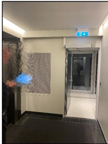
Figur 39: Trykkavlastning med sjeld til trykkavlastningssjakt. Bildet tatt av Jonathan Lundblad 10/03/22
