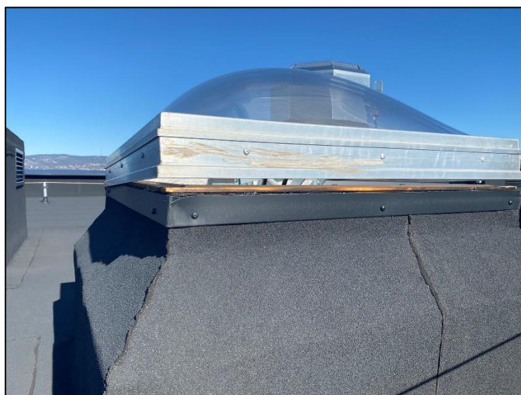
Figur 82: Åpningen i røykluken på trapp D2, lukene i de to andre trapperommene hadde tilsvarende åpningsgrad. D2 og D3 hadde lik innvendig lukestørrelse på 1 x 1 m, men D1 var 1,2 x 2,4 m. Bildene tatt av Jonathan Lundblad 20/04/22
