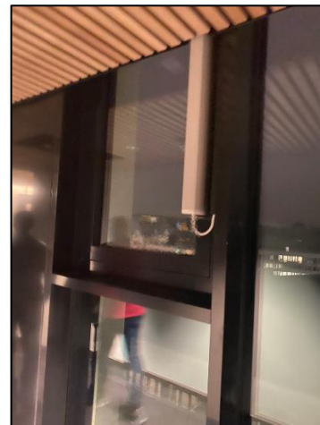
Figur 40: Trykkavlastning i fasade. Bildet tatt av Jonathan Lundblad 10/03/22
