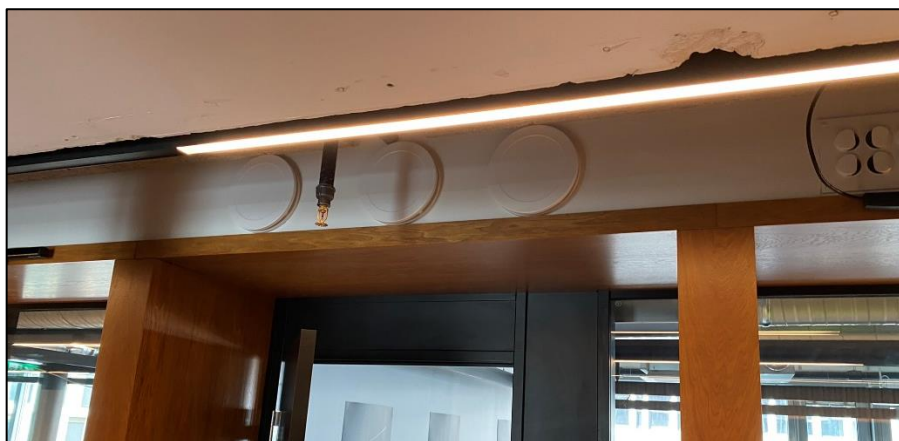
Figur 49: Overstrømningsventiler mellom trapperommet og trykkavlastningen i et. 5. Bildet tatt av Jonathan Lundblad 12/06/22
