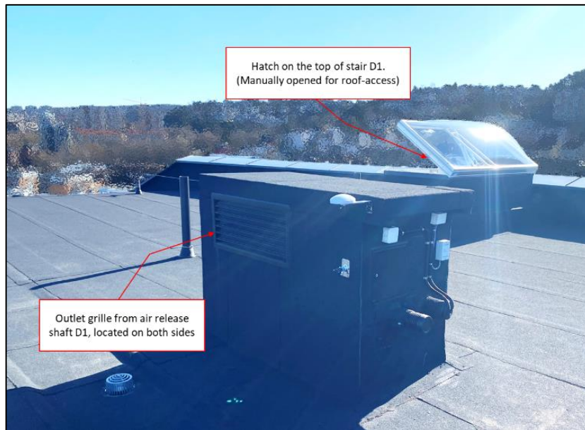
Figur 86: Trykkavlastningssjaktene var avsluttet med to rister, på 0,35 \text{ m} \times 1 \text{ m} Tegninger viste ingen sjeld eller mekanismer bak ristene. Bildene tatt av Jonathan Lundblad 20/04/22
