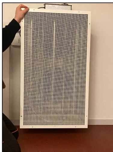
Figur 32: Spjeld i bunnen av trapperommet. Bildet tatt av Jonathan Lundblad 26/01/22
