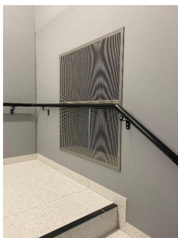
Rist mellom trapperom D3 og viftene, én til rist ble ikke avbildet.
