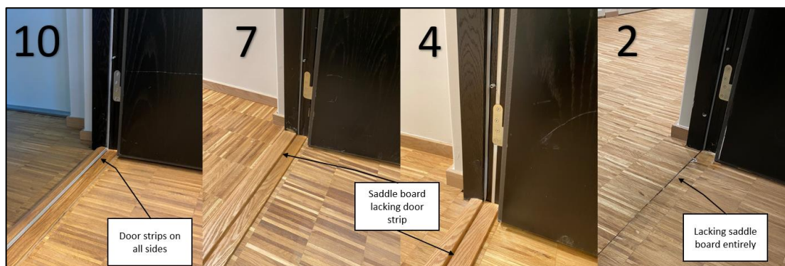
Figur 58: Bilder av dørterskelen ved etasjer hvor måleinstrument var plassert, hhv. 10, 7, 4, og 2 etasje. Det ble funnet stor variasjon i lekkasjetetthet. Bildet tatt av Jonathan Lundblad 05/06/22
