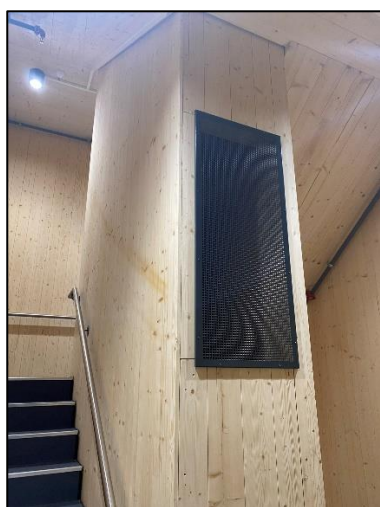
Figur 35: Hovedtrappen i X3 var tilrettelagt med jevn distribusjon av luft. Bildet tatt av Jonathan Lundblad 28/02/22
