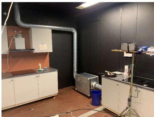
Figur 7: Benkeventilatoren – uttrekking modus.
