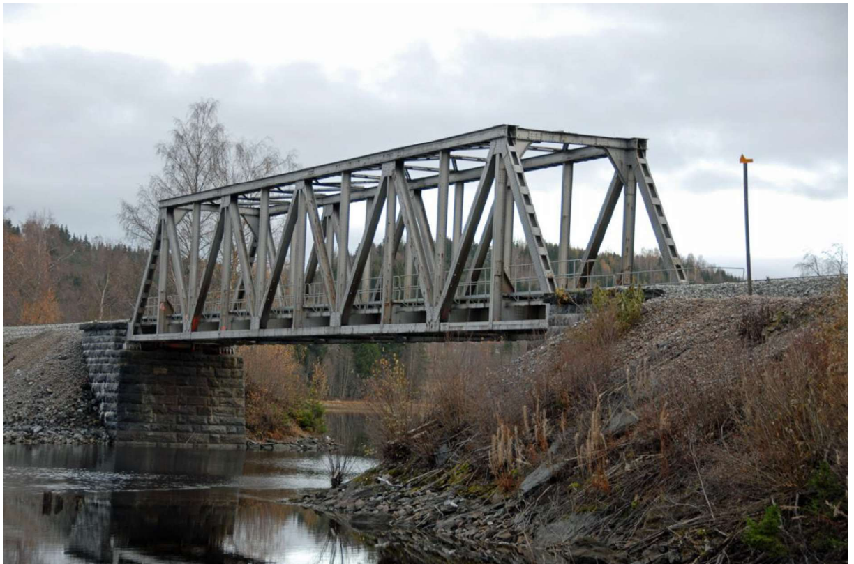
Figur 2: Fagverk har vært avgjørende i utviklingen til moderne brubygging (Sunnan jernbanebru, u.å.)
