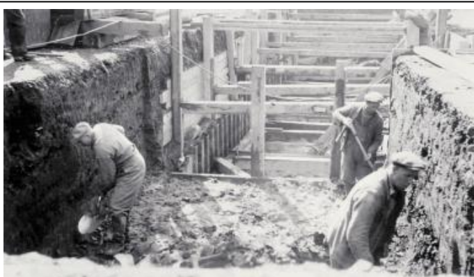
Bilde 4: Grøftegraving og legging av kloakkrør var tungt fysisk arbeid, og all graving ble utført for hånd. Bildet viser arbeidere fra Vann- og kloakkvesenet under arbeidet med hovedkloakken i Kongens gate på 1920-tallet.
