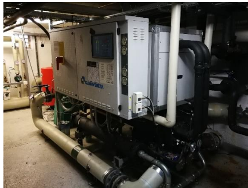
Figur 16 Bilde av varmpumpen tatt under befaring ved Berg Fengsel
