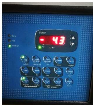
Figur 30 Bilde av varmepumpens display som viser fluidtemperatur fra brønn inn på varmepumpen. Bilde tatt fra befaring (7.mars 2018).
