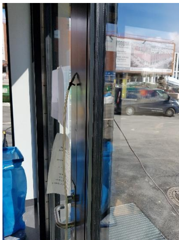
Figur 3. Montering av rør for måling av trykkdifferanse over fasade. [Foto: M. Smidt].
