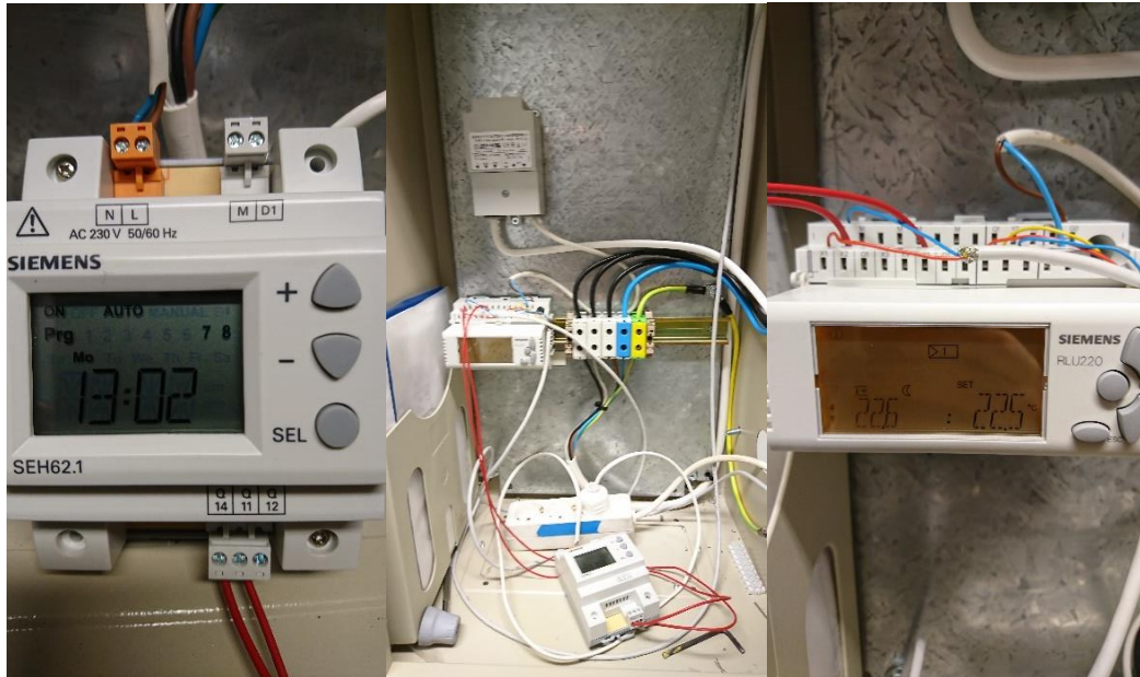
Figur 12. Fra høyre til venstre: Tidsur, sammenkobling av tidsur og PLS-styrer, PLS styrer
