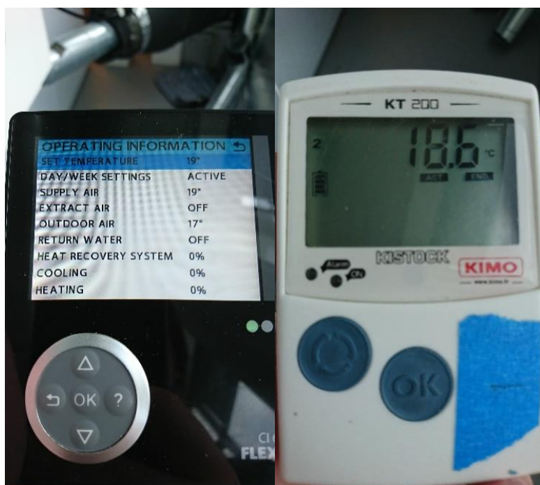
Figur 11. Til høyre: Settpunktstemperatur for driftstid til temperatur og luftmengde. Til venstre: Monitor for tilluftstemperatur
