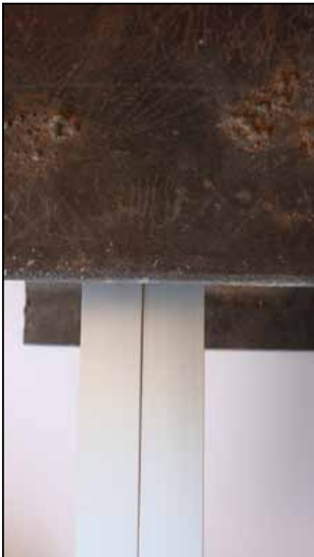
Mange muligheter innen aluminiumsprofiler, men var helt feil til en rusten stålbjelke.
